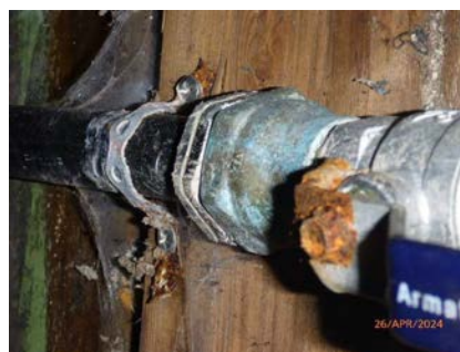
Plast på vannledning i krypkjeller.
