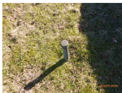
Utvendig stoppekran i nord.
