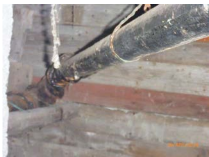
Støpejernsrør i kjrypkjeller.
