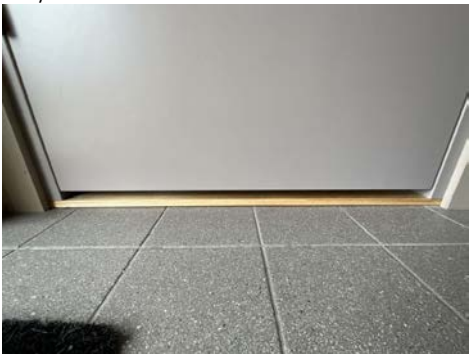
Spalte under dør.
