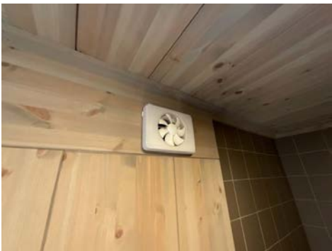
Elektrisk styrt vifte.
