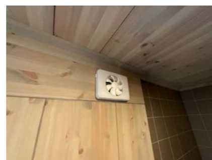
Elektrisk styrt vifte.
