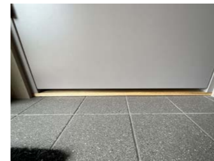
Spalte under dør.
