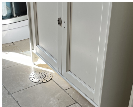
Svelleskader i servantskap
