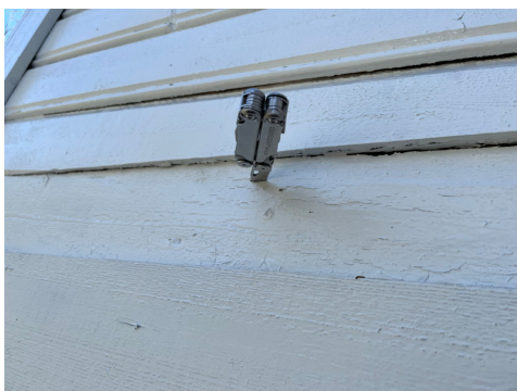
Råte i "vindski" ved balkong mot øst.
