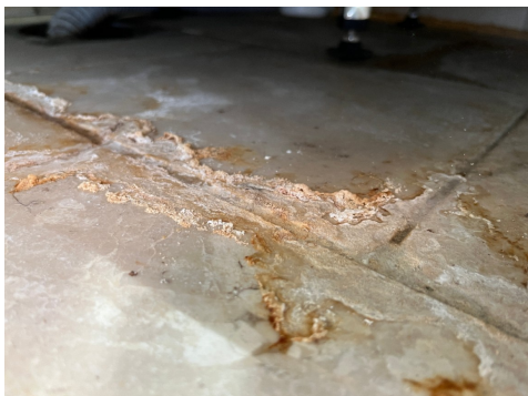
Saltutslag i fuger under kabinett
