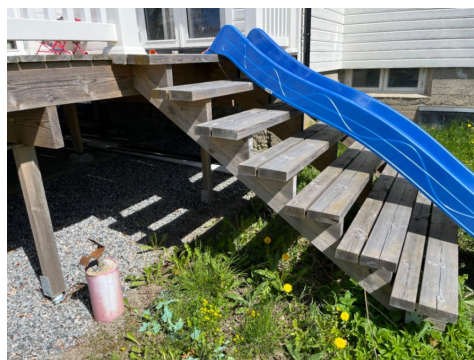
Manglende rekkverk på trapp.
