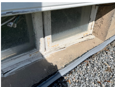
Råteskader i kjellervinduer
