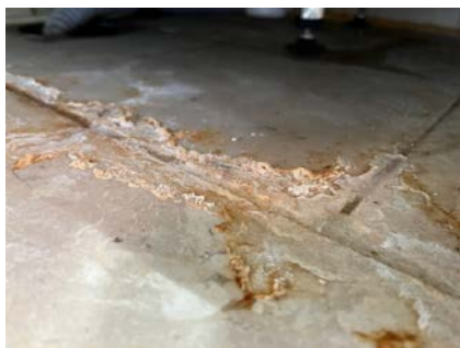
Saltutslag i fuger under kabinett
