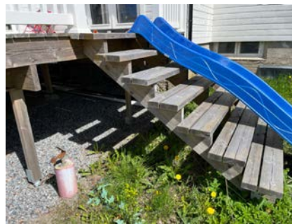
Manglende rekkverk på trapp.
