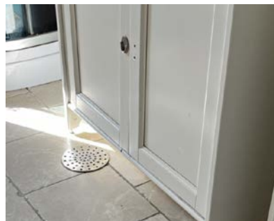
Svelleskader i servantskap
