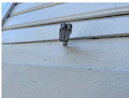
Råte i "vindski" ved balkong mot øst.
