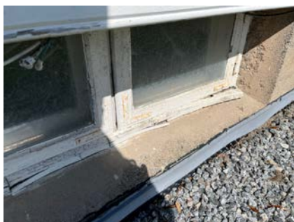
Råteskader i kjellervinduer
