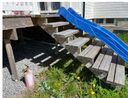
Manglende rekkverk på trapp.
