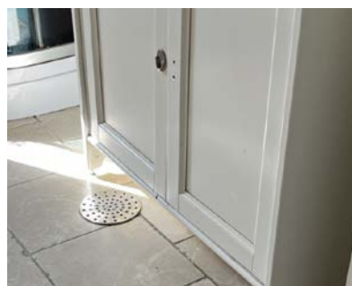
Svelleskader i servantskap
