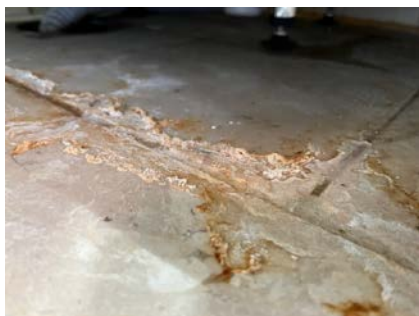
Saltutslag i fuger under kabinett
