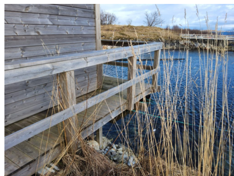
For store åpninger i rekkverk.
