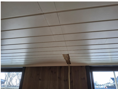
Det er skader i himling. Årsaken er at utstyr/konstruksjoner har blitt fjernet og etterlatt merker/hull. Bildet er tatt over der kjøkken skal monteres.
