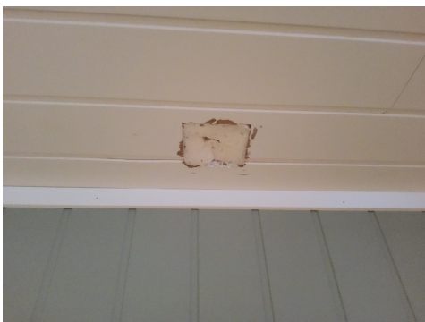
Det er skader i himling. Årsaken er at utstyr/konstruksjoner har blitt fjernet og etterlatt merker/hull. Bildet er tatt på soverom.
