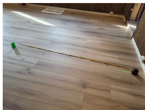
Det er høydeforskjell på gulv mot grunn ut over standardens krav til måleavvik. På betonggulv kommer dette som regel av ujevnheter i betongoverflate fra støping av gulv. Det kan også være setninger. Eksakt årsak er ikke mulig å fastslå. Bildet er tatt i stue.
