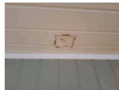
Det er skader i himling. Årsaken er at utstyr/konstruksjoner har blitt fjernet og etterlatt merke/hull. Bildet er tatt på soverom.
