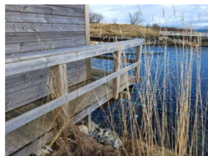
For store åpninger i rekkverk.
