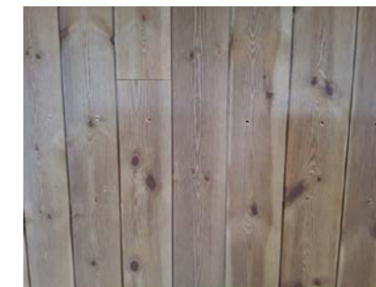
Det er skader på vegger som består av merke og skruer. Årsaken er at gjenstander som har vært montert/hengt på vegg har blitt fjernet. Bildet er tatt i stuen.
