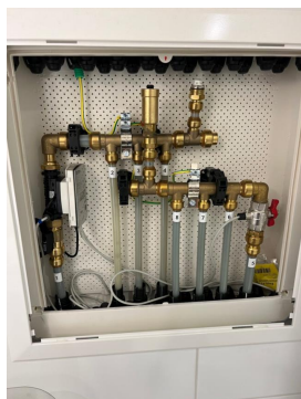
Rørskap for oppvarming/varmtvann.
