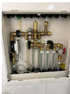
Rørskap for oppvarming/varmtvann.
