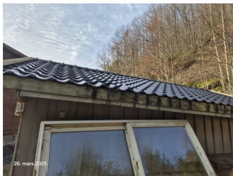
Manglende takrenner og nedløp på garasjen.
