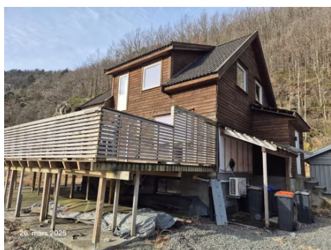
Manglende takrenner og nedløp på boligen.
