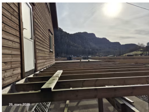
Manglende terrassebord og rekkverk.
