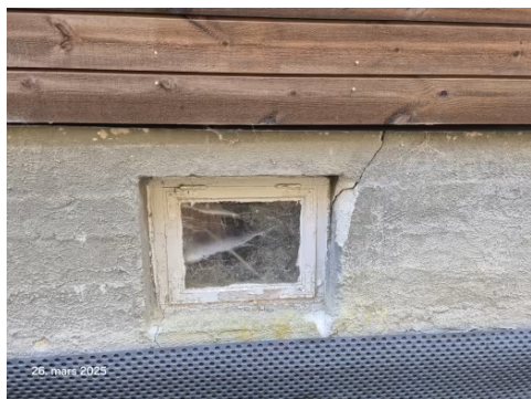
Sprekk i mur.
