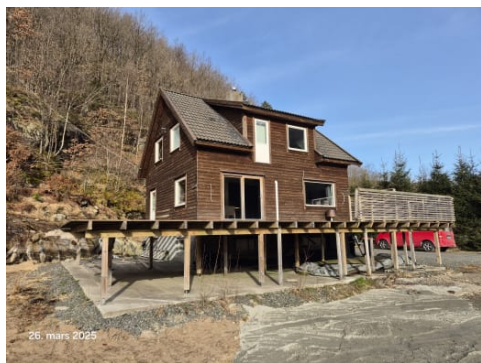
Bildet viser manglende rekkverk.
