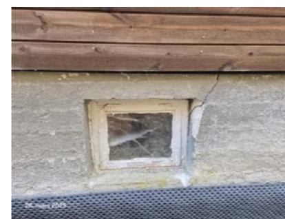
Sprekk i mur.
