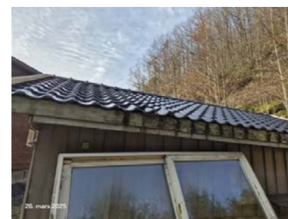
Manglende takrenner og nedløp på garasjen.
