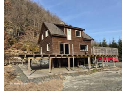
Bildet viser manglende rekkverk.
