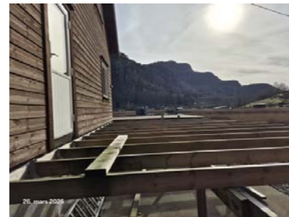
Manglende terrassebord og rekkverk.
