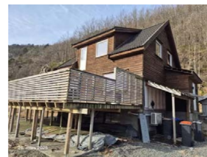
Manglende takrenner og nedløp på boligen.
