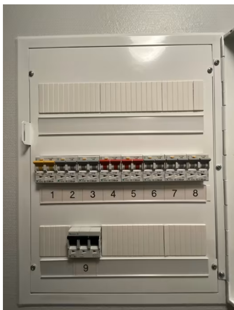
Viser innfelt sikringsskap plassert i bod/teknisk rom.
