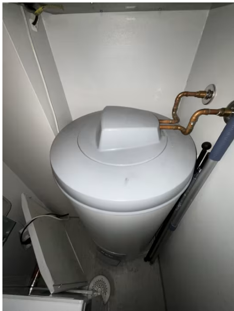
Viser bereder plassert i bod/teknisk rom.
