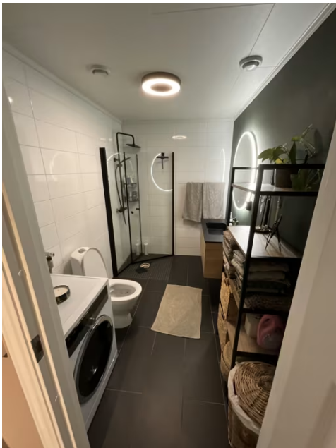
Viser installasjoner på bad.
