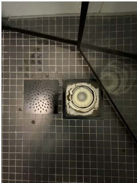
Viser sluk i dusjsonen.
