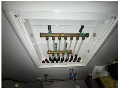
Vannrør med rør i rør system fra fordelerskap plassert i bod og frem til sanitærinstallasjoner på badetrom og kjøkken.
