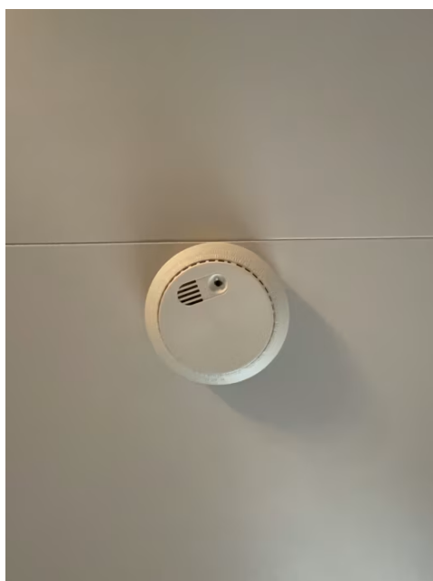
Viser brannvarsling montert i stue.
