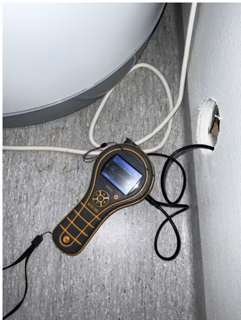
Det er foretatt hulltaking med 73 mm hullbor fra tilstøtende rom (bod). Undersøkelsen viser ingen tegn til skader eller fukt i konstruksjonen.
