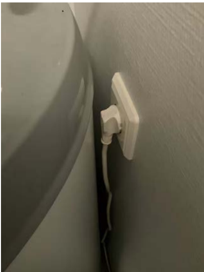
Støpsel kunne ikke sjekkes. For trangt mellom bereder og støpsel.
