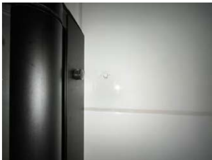
Viser merker etter tidligere oppheng. Mindre sprekk i flis registrert ved hull.
