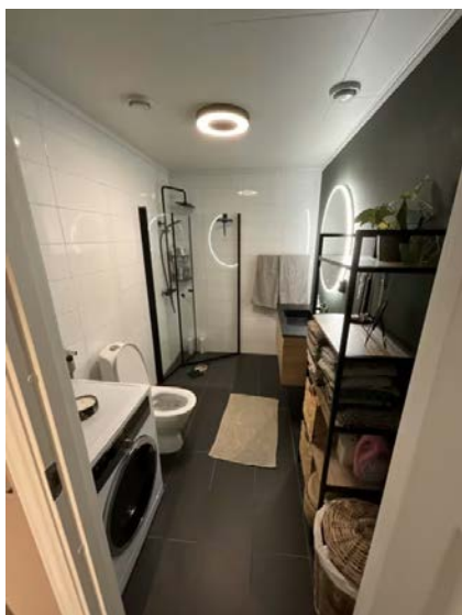
Viser installasjoner på bad.
