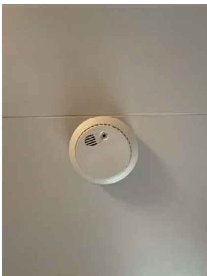
Viser brannvarsling montert i stue.
