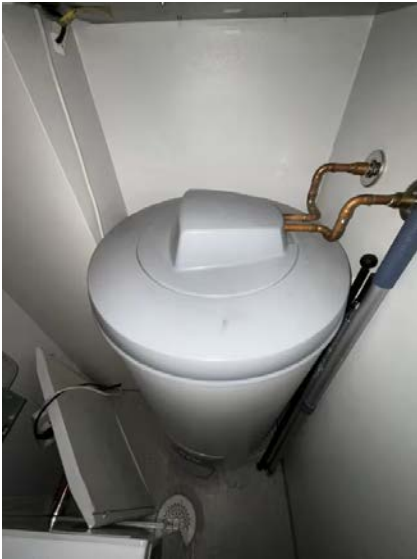
Viser bereder plassert i bod/teknisk rom.
