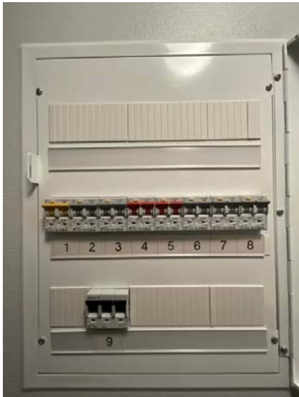
Viser innfelt sikringsskap plassert i bod/teknisk rom.
