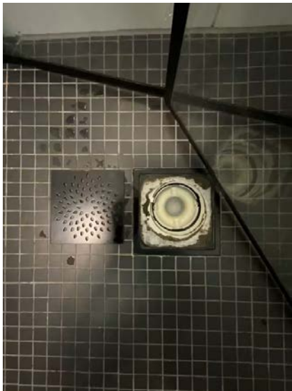
Viser sluk i dusjsonen.
