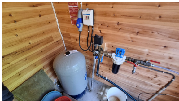
Vanninstallasjoner er plassert i vannhus.
