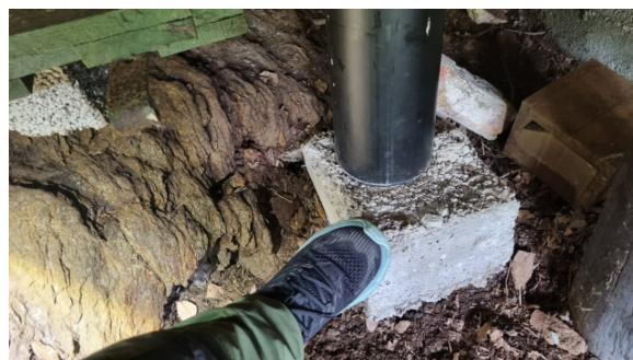
Det er registrert utglidning eller utvasking av masser under fundamentet, noe som har ført til at fundamentet står ustøtt og har fått redusert bæreevne.
