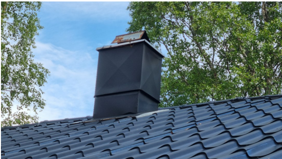
Pipebeslag har overflaterust
