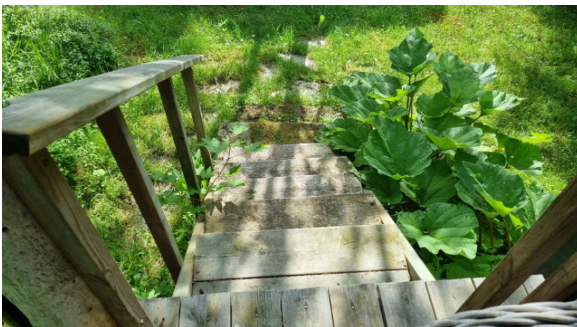
Det er ikke rekkverk på begge sider.
