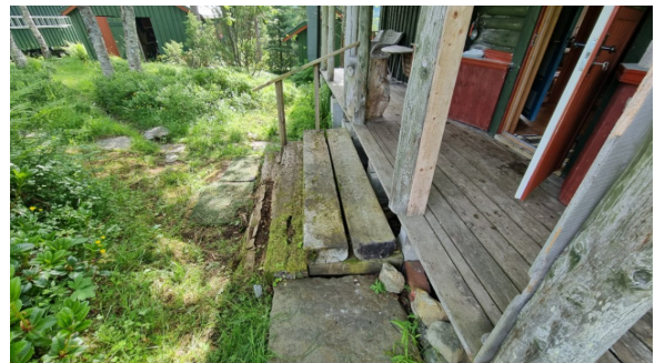
Trappetrinn/sviller har råteskader
