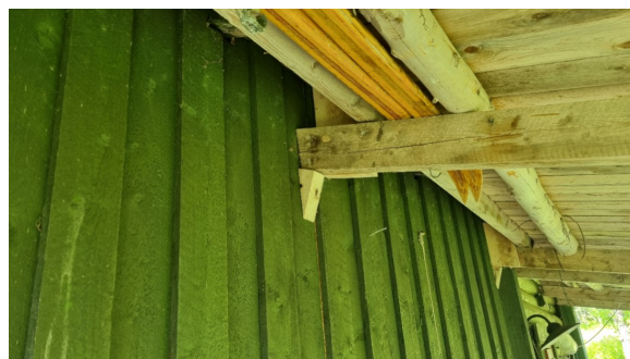
Takoverbygg er ikke tilfredsstillende festet i yttervegg.
