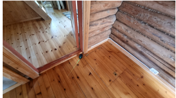
Kontroll av planavvik.
