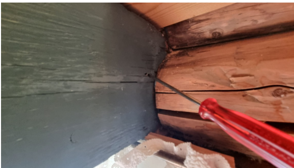
Råteskader i gulvbjelke for hems
