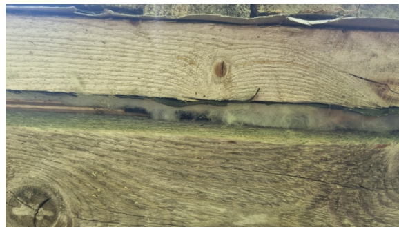
Det er registrert synlig isolasjon/isolasjonsmatter i nedkant av ytterveggene.
