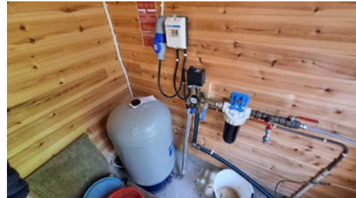
Vanninstallasjoner er plassert i vannhus.
