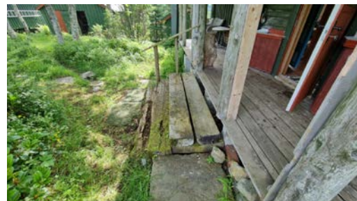
Trappetrinn/sviller har råteskader
