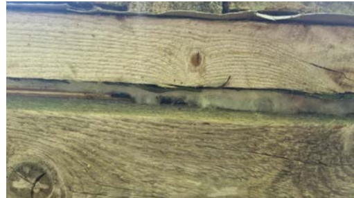
Det er registrert synlig isolasjon/isolasjonsmatter i nedkant av ytterveggene.
