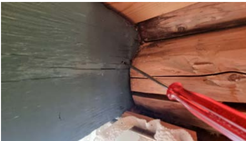
Råteskader i gulvbjelke for hems
