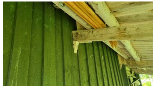
Takoverbygg er ikke tilfredsstillende festet i yttervegg.
