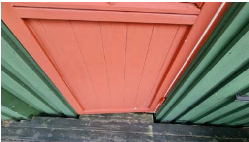
Malingsavflassing i nedkant på dørblad.
