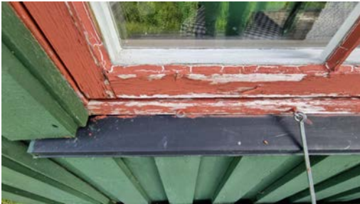
Vindu er værslitt.
