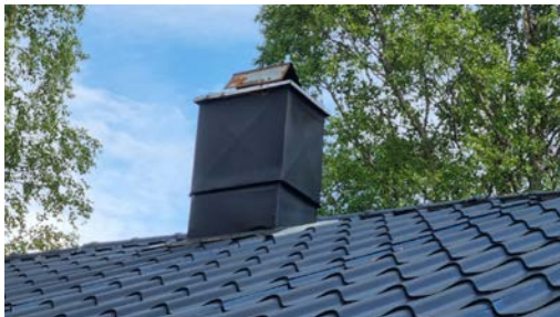
Pipebeslag har overflaterust
