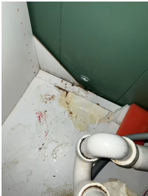
Viser skade på bunnplate under vask.
