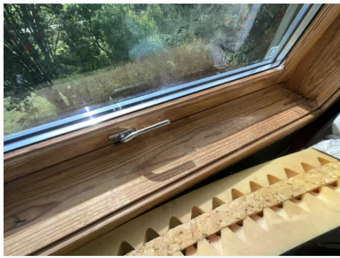
Det registreres slitasjemerker på foring ved vindu i 2.etasje
