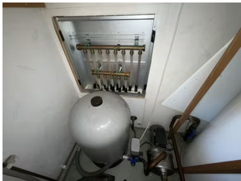
Viser fordelerskap, trykktank, vannpumpe og hovedstoppekran plassert på bad.
