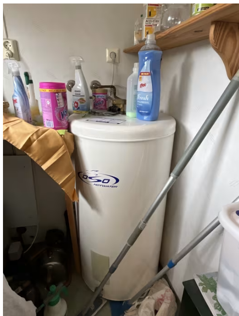
Viser varmtvannsbereder plassert på bad.
