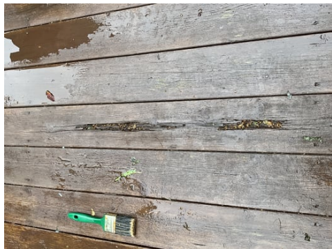
Viser råteskader på terrassebord.
