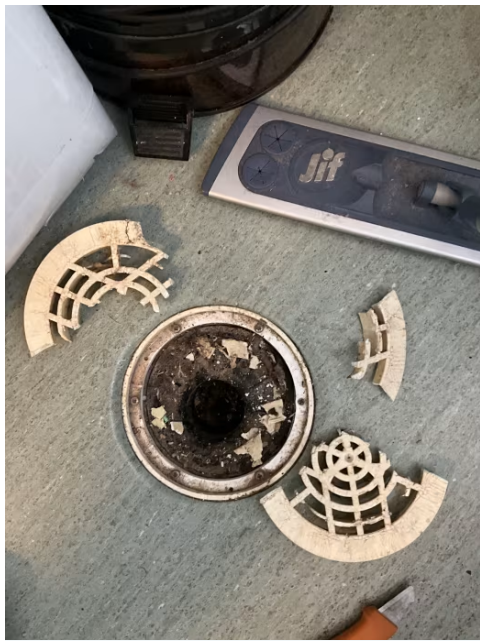
Viser sluk ved oppvaskmaskin og bereder.
