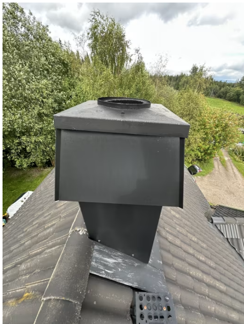
Viser pipebeslag over tak. Regnshjerm mangler.
