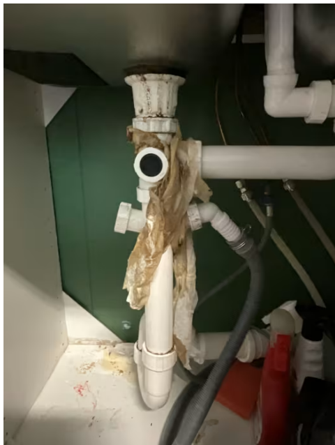
Det er påvist tegn på lekkasjer fra avløpsrør.
