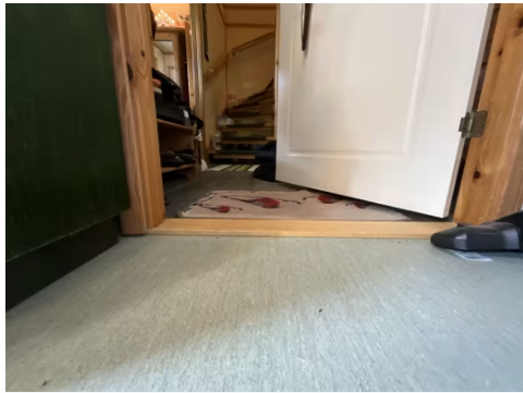
Ingen oppbrett av tettesjikt mot døråpning.
