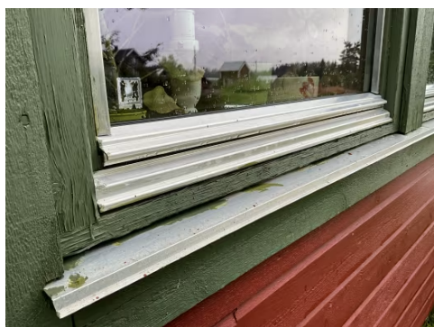
Vinduer utvendig med behov for overflatebehandlinger.
