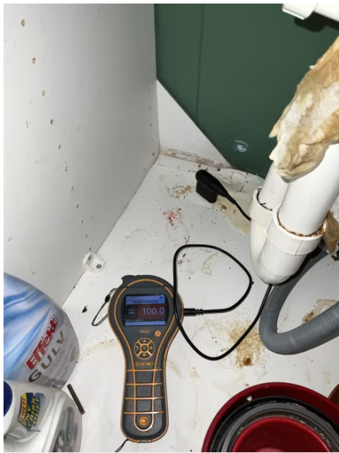
Viser fullt utslag på fukt under vask.
