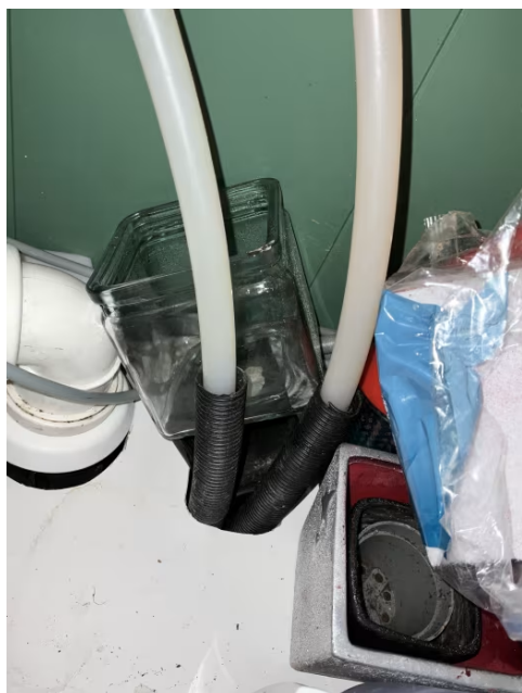
Manglende endemuffer ved røravslutninger ved rør i rør system inne i kjøkkenbenk.
