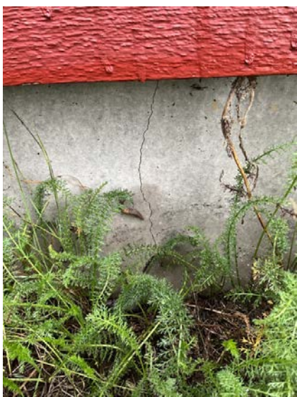
Det registreres mindre riss i grunnmursplate.
