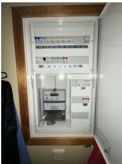
Viser innfelt sikringssskap plassert i gang 1.etasje
