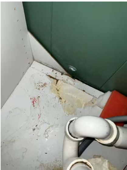
Viser skade på bunnplate under vask.
