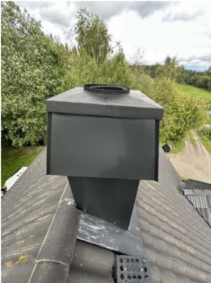
Viser pipebeslag over tak. Regnskjerm mangler.
