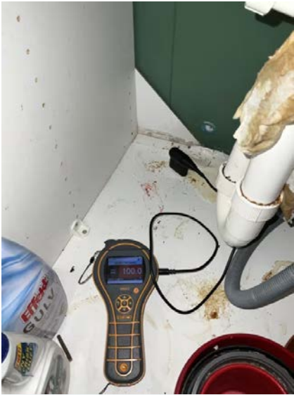
Viser fullt utslag på fukt under vask.
