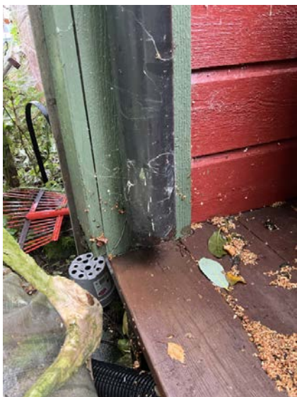
Taknedløp er avsluttet over bakken uten utkast ved terrasse.
