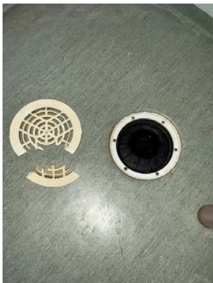
Viser sluk i dusjonen.
