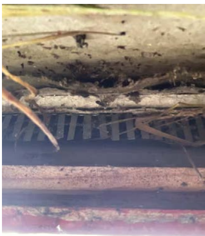
Viser underkant av kledningen. Det registreres for store glipper ved musebånd slik at denne ikke virker som tiltenkt.
