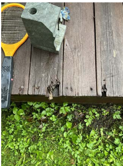
Stedvis råteskader registreres.
