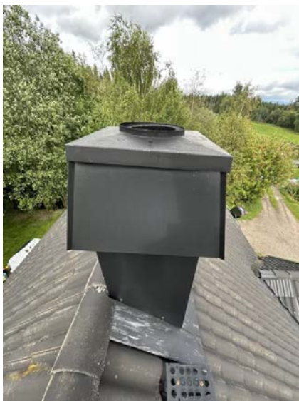
Viser pipebeslag over tak. Regnskjerm mangler.
