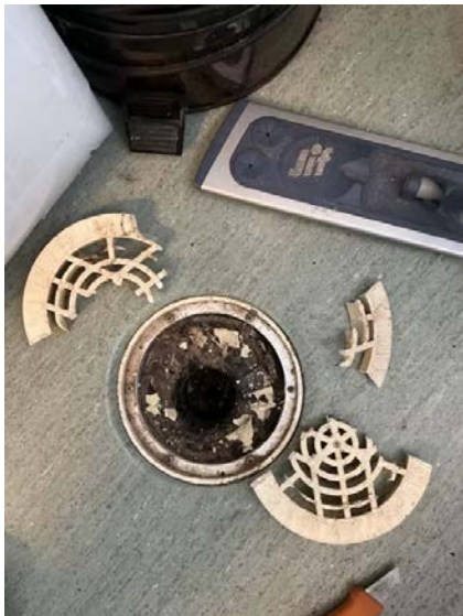
Viser sluk ved oppvaskmaskin og bereder.
