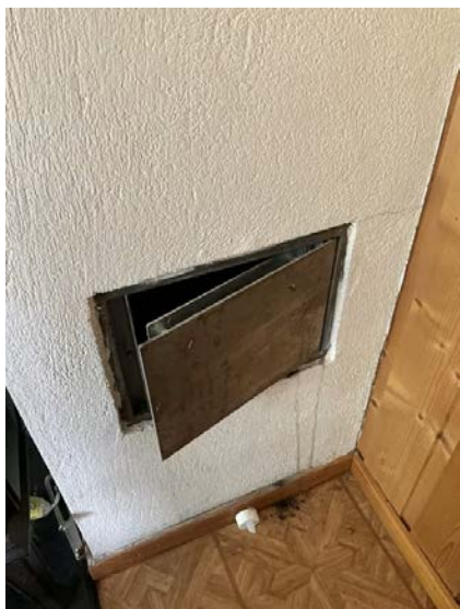
Viser sotluke. Mindre riss i puss ved sotluke registreres.
