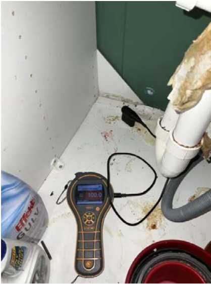
Viser fullt utslag på fukt under vask.
