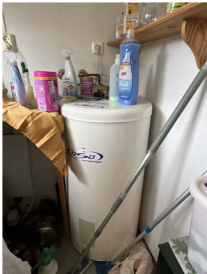
Viser varmtvannsbereder plassert på bad.
