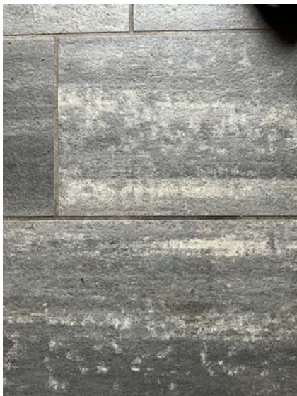
Det registreres boom under gulvfliser og sprekker i flis i gang.
