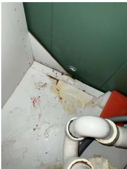
Viser skade på bunnplate under vask.
