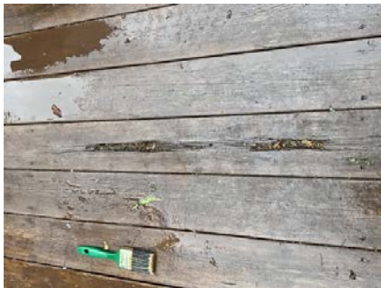
Viser råteskader på terrassebord.
