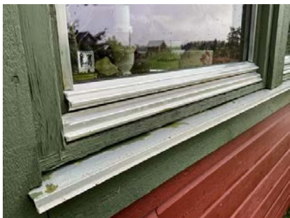
Vinduer utvendig med behov for overflatebehandlinger.
