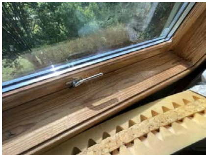
Det registreres slitasjemerker på foring ved vindu i 2.etasje
