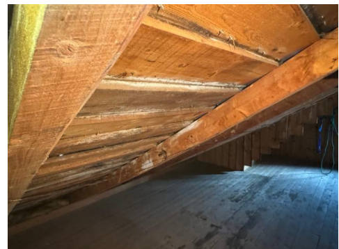
Langt taksperr med nedbøying.
