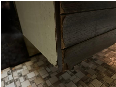
Fuktskade på baderomsinnredning.
