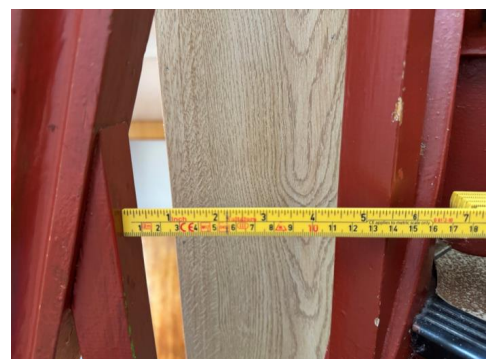
Åpninger i rekkverk er over 10 cm.
