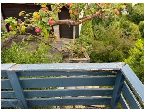
Råte i rekkverksbord.
