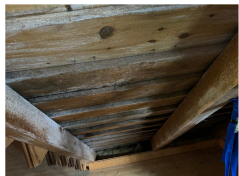
Misfarging i sutak.
