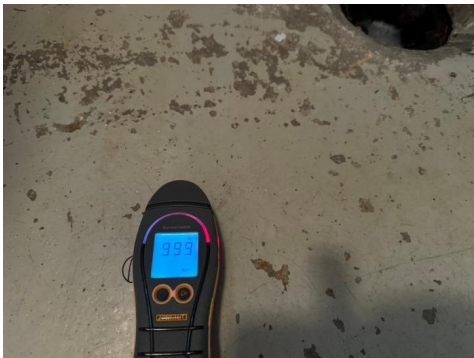
Forhøyede fuktverdier i betonggulv.
