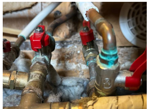
Irr på kobberrør i gang/trapperom i u-etg.
