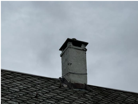
Malingsflass/slitasje på pipe utvendig.
