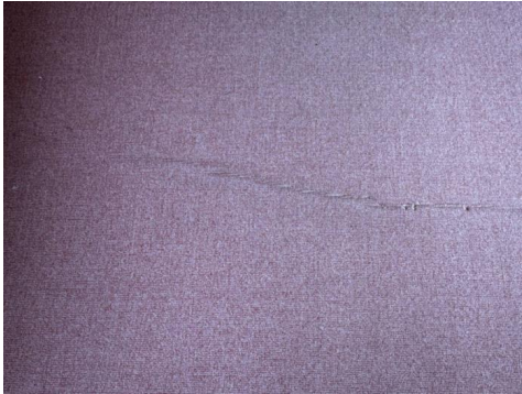
Slitasje/ujevnt teppe i loft-etg.
