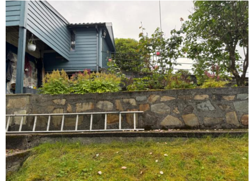
Forstøtningsmur uten rekkverk.
