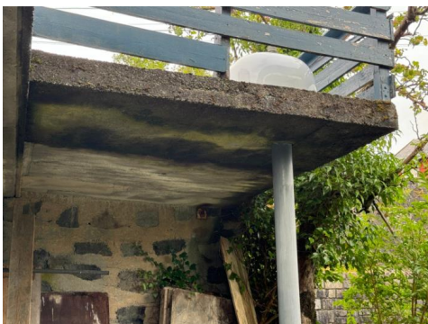
Slitasje i betongdekke v/ forstøtningsmur.
