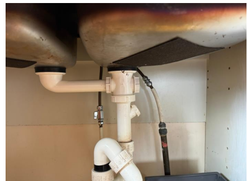
Rørproppleg under vask.
