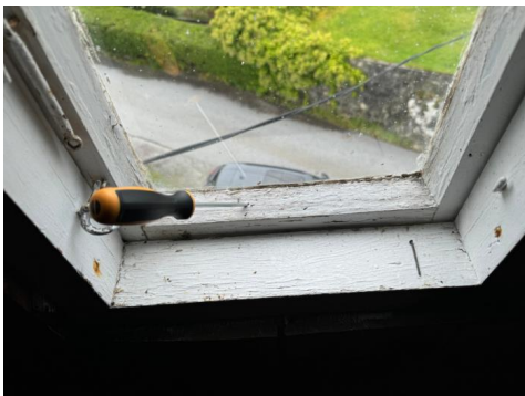
Lokal råte i eldre loftsvindu.
