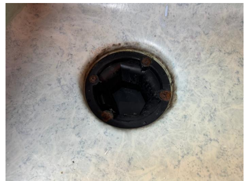
Eldre plastsluk i gulv.
