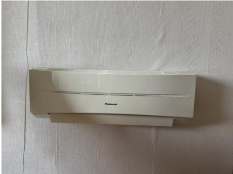
Varmepumpe med uttak i stue.
