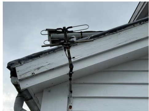
Råte i vindskibord.
