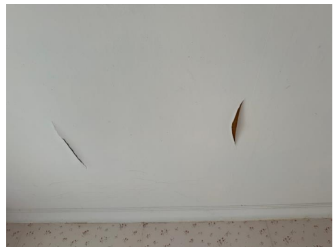
Rift i himling i loft-etg.
