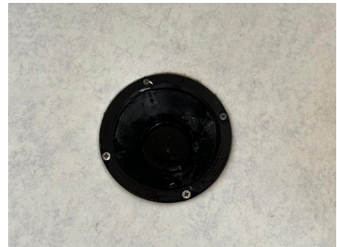
Eldre plastsluk i gulv.
