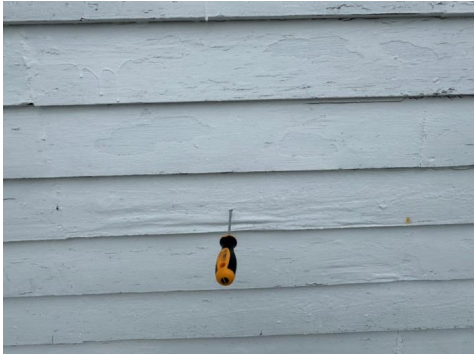
Råte i kledningsbord.
