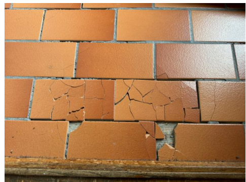
Ødelagte gulvfliser i entre.
