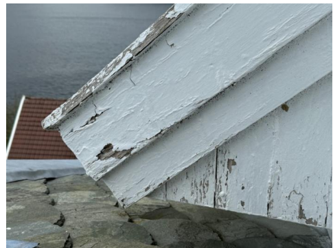
Råte i vindskibord.
