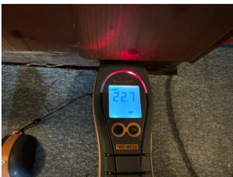
Forhøyede fuktverdier i nedre del av skillevegg. Det skyldes sannsynligvis fuktopptrekk fra betonggulv.
