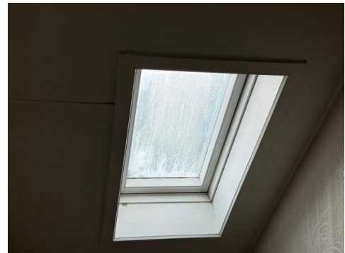
Punktert isolerglass i takvindu i gang/trapperom.
