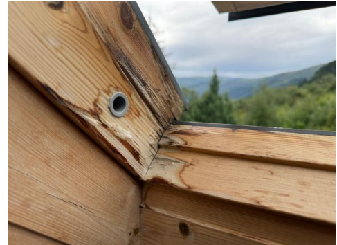
Fuktmerker i takvindu på bad.
