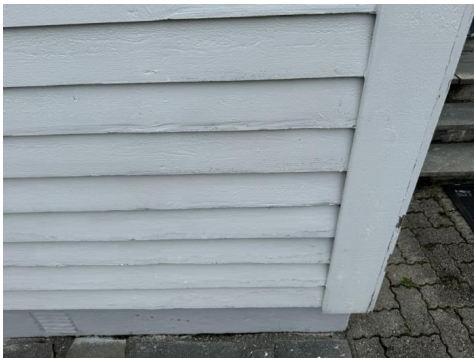
Råte i kledning, spesielt på fasade mot vest.
