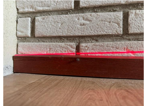
Bilder viser skjevheter i gulv i loftstue.
