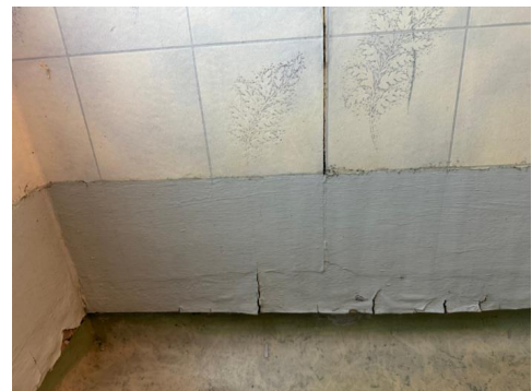
Slitasje i nedre del av veggplater i dusjsone.
