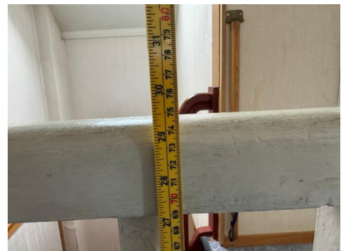
Rekkverkshøyde er under 90 cm.
