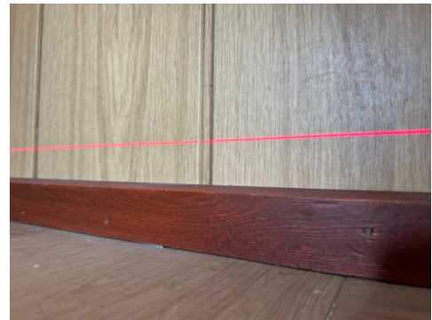
Bilder viser skjevheter i gulv i loftstue.
