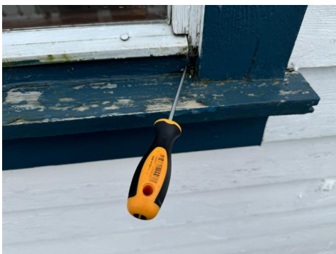
Lokal råte i eldre stuevindu.
