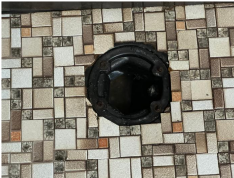
Eldre plastsluk i gulv.
