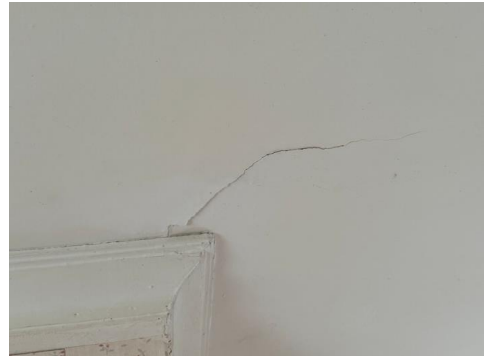
Rift i himling i loft-etg.
