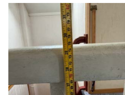
Rekkverkshøyde er under 90 cm.
