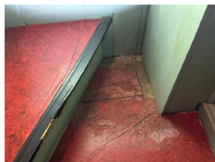
Stor slitasje i vinylbelegg i trapp til u-etg.
