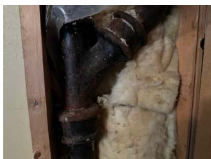
Rust på avløpsrør i u-etg.
