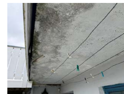
Slitasje og malingsflass på underside av altan. Det indikerer fuktvandring i betongdekke på indre altandel.
