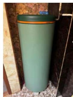
Varmtvannstank på bad i u-etg.
