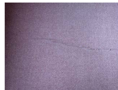
Slitasje/ujevnt teppe i loft-etg.
