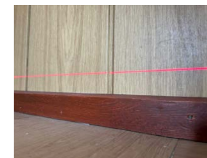
Bilder viser skjevheter i gulv i loftstue.
