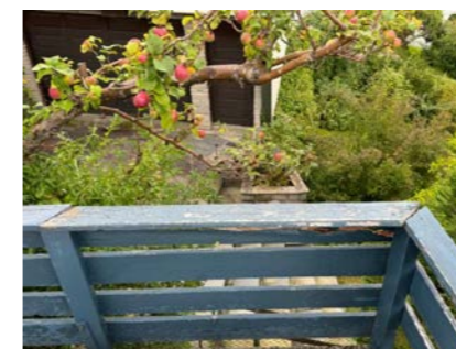
Råte i rekkverksbord.
