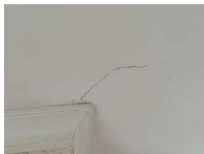
Rift i himling i loft-etg.
