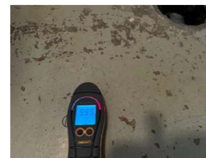
Forhøyede fuktverdier i betonggulv.
