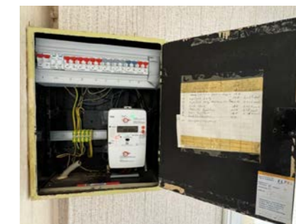
Sikringsskap i gang/trapperom i loft-etg.
