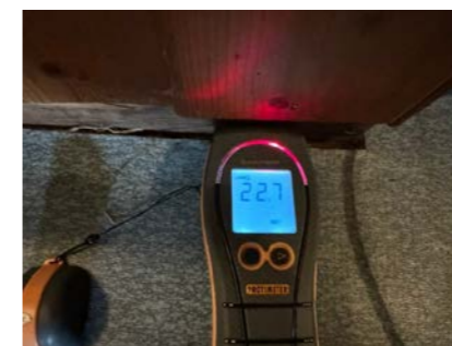
Forhøyede fuktverdier i nedre del av skillevegg. Det skyldes sannsynligvis fuktopptrekk fra betonggulv.
