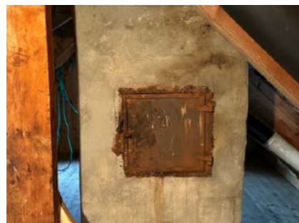
Feieluke på koffertloft. Rust ble observert på både feieluke og sotluke.
