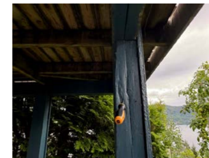
Råte i søyle på liten del som vender mot sør.
