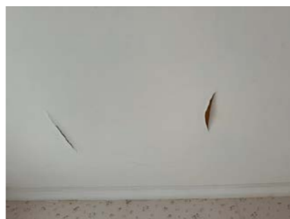
Rift i himling i loft-etg.
