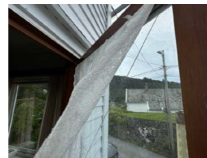
Sprekk i glass på altandør.
