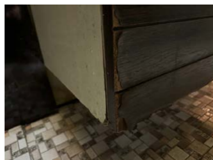
Fuktskade på baderomsinnredning.
