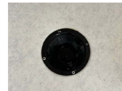
Eldre plastsluk i gulv.
