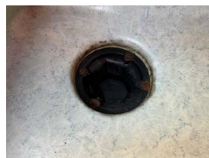
Eldre plastsluk i gulv.
