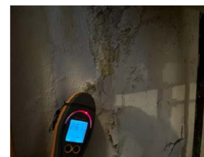
Forhøyede fuktverdier på innsiden av grunnmur i vaskekjeller.
