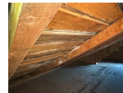
Langt taksperr med nedbøyning.
