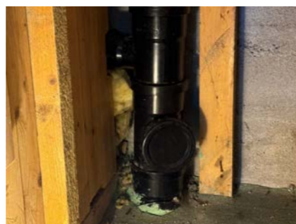
Stakeluke på avløpsrør i u-etg.
