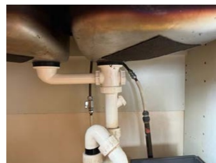
Rørproplegg under vask.
