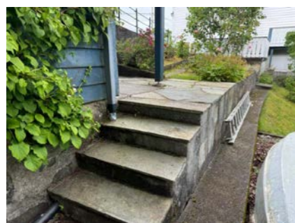
Utvendig trapp v/ garasje/bod. Det bør monteres rekkverk hvor det er størst nivåforskjell.
