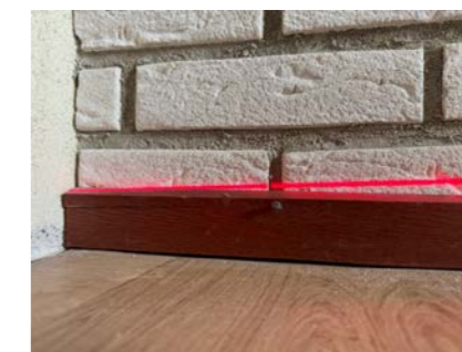
Bilder viser skjevheter i gulv i loftstue.
