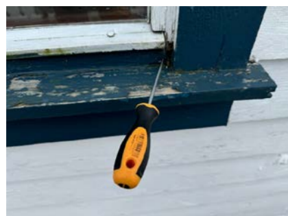
Lokal råte i eldre stuevindu.
