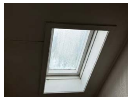
Punktert isolerglass i takvindu i gang/trapperom.
