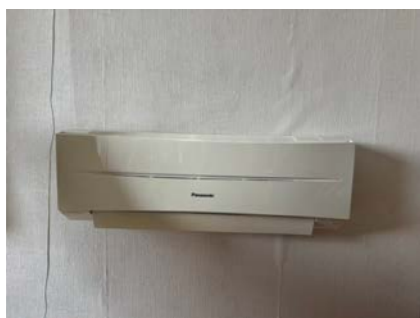
Varmepumpe med uttak i stue.
