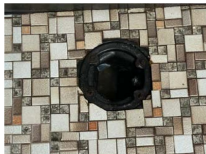
Eldre plastsluk i gulv.
