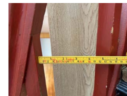
Åpninger i rekkverk er over 10 cm.
