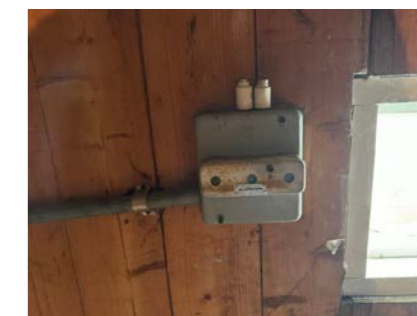
Inntakssikring på koffertloft.
