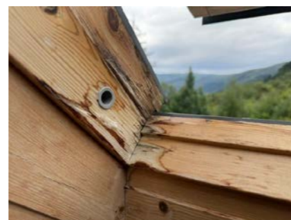
Fuktmerker i takvindu på bad.
