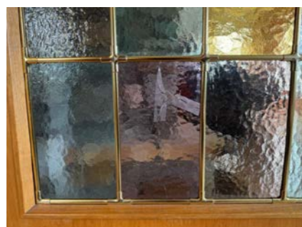
Sprekk i glass i innerdør med blyinnfattet glass mellom gang/trapperom - stue.
