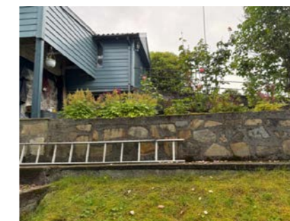
Forstøtningsmur uten rekkverk.
