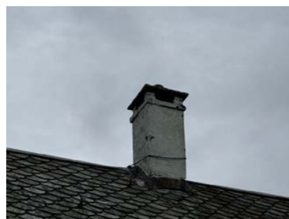
Malingsflask/slitasje på pipe utvendig.
