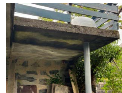
Slitasje i betongdekke v/ forstøtningsmur.
