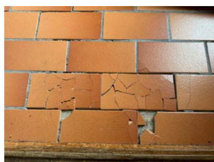
Ødelagte gulvfliser i entre.
