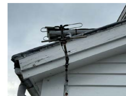
Råte i vindskibord.
