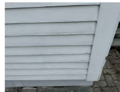
Råte i kledning, spesielt på fasade mot vest.
