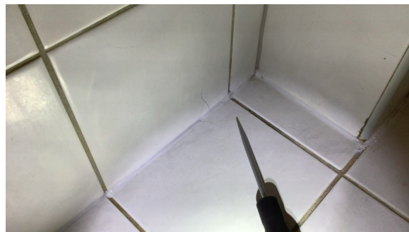
Det er sprekk i flis i dusjsonen.
