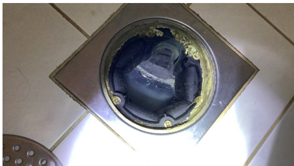
Det er ikke synlig membran i sluk
