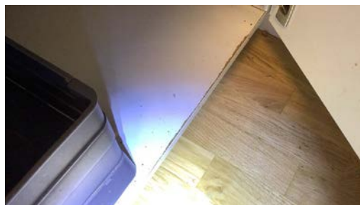
Slitasje i plate under oppvaskbenk.
