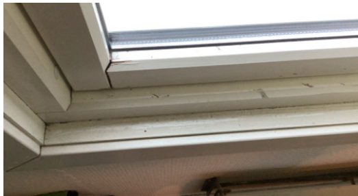
Enkelte kondensmerker i karm.
