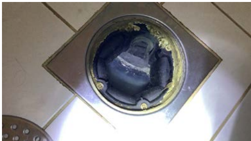
Det er ikke synlig membran i sluk
