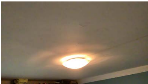
Dels ujevn overflate i himlinger.
