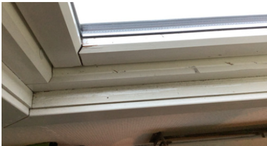
Enkelte kondensmerker i karm.
