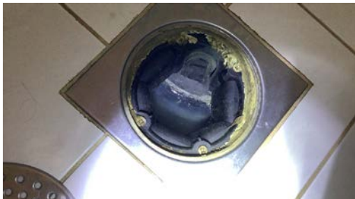
Det er ikke synlig membran i sluk
