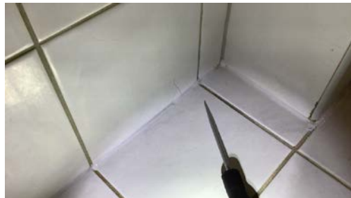
Det er sprekke i flis i dusjsonen.
