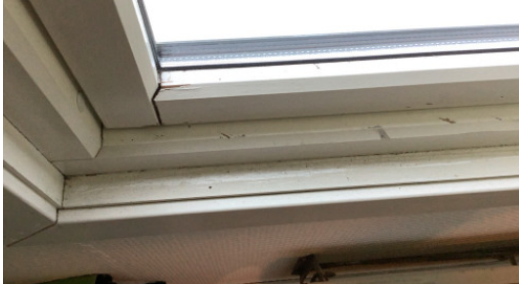
Enkelte kondensmerker i karm.
