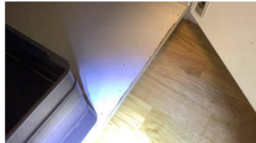
Slitasje i plate under oppvaskbenk.
