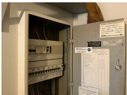
Automatsikringer i sikringsskap plassert i gang.
