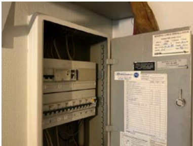
Automatsikringer i sikringsskap plassert i gang.
