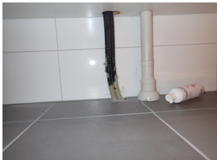
Vannrør under benken
