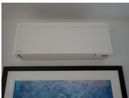
Varmepumpe i stuen
