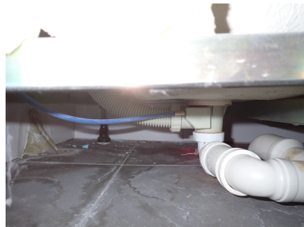
Vannrør under badekar
