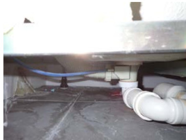
Vannrør under badekar
