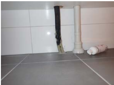
Vannrør under benken
