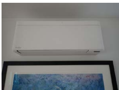
Varmepumpe i stuen
