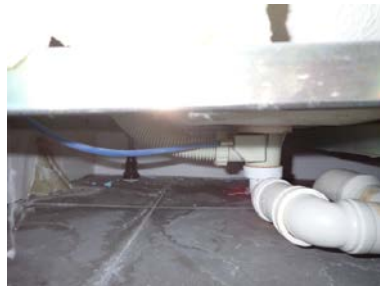
Vannrør under badekar
