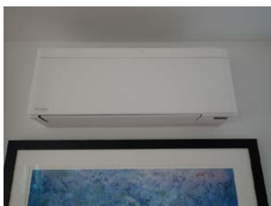
Varmepumpe i stuen
