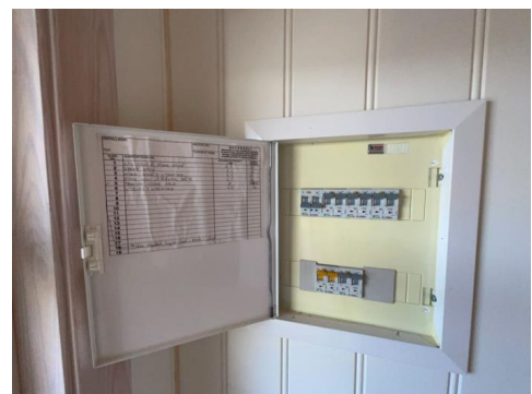
Sikringskapp. Underskap i annekset.
