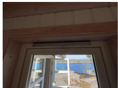
Eksempel på montert ventil i vindu.
