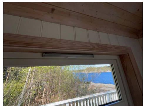
Eksempel på montert ventil i vindu.
