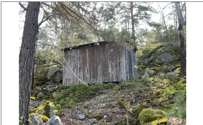
Gammel bod nr 2 på eiendommen, denne er det rivningsvedtak på .
