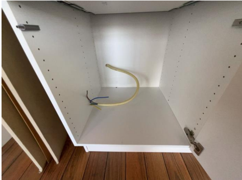
Ledning uten enesikkring.
