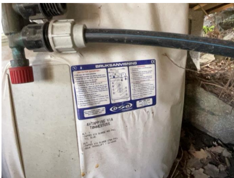
Spekk på varmtvannstank.
