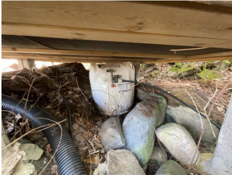
Varmtvannstank. Spekk på varmtvannstank.
