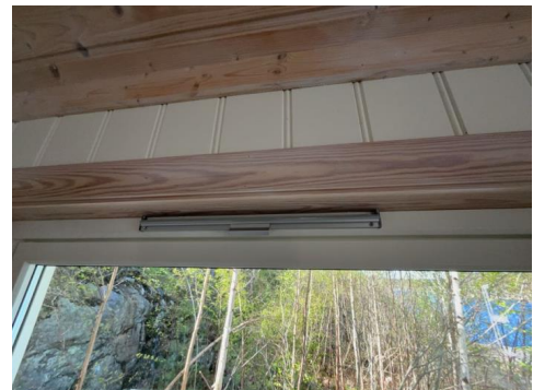
Eksempel på montert ventil i vindu.
