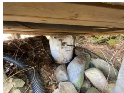
Varmtvannstank. Spekk på varmtvannstank.
