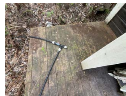
Vann tilført til annekset, dette gir vannforsyning til utekjøkken.
