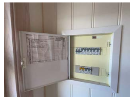
Sikringskap. Underskap i annekset.
