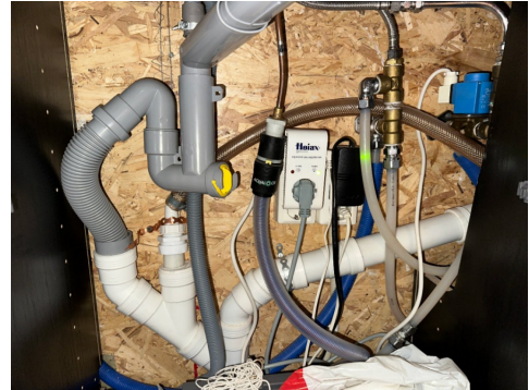
Rørpropplegg i kjøkkenbenk med Waterguard
