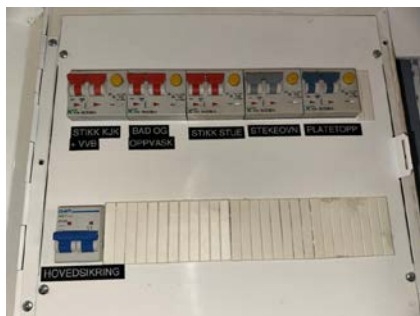
Sikringsskap med automatsikringer.
