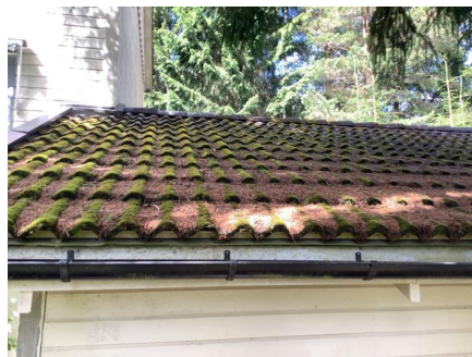
Tak må vaskes. Mangler beslag ned i takrenner.
