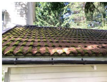
Tak må vaskes. Mangler beslag ned i takrenner.
