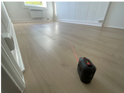
Nivellering soverom, avvik ca. 10-20 mm
