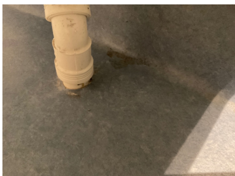
Gjennomføring i belegg under vasken
