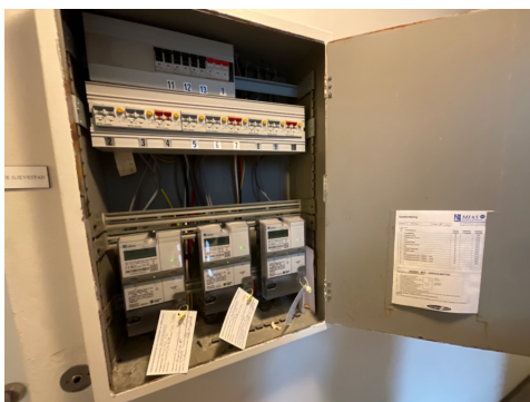
Sikringsskap i felles trappegang
