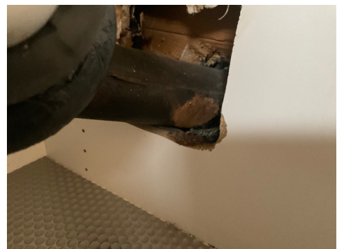
Rust på avløpsrør i kjøkkenskapet
