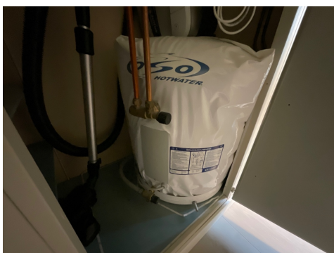
Varmtvannstank i garderoben i soverommet
