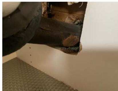
Rust på avløpsrør i kjøkkenskapet
