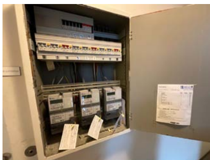
Sikringskap i felles trappegang
