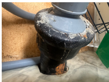
Rust og tegn til utettheter på avløpsrør i kjøkkenskap.
