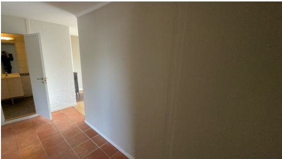
Synlige sparkelskjøter på veggplater.
