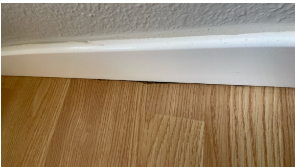
Glippe mellom gulvlist og laminatgulv.
