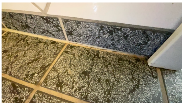
Sprekk i elastisk fuge
