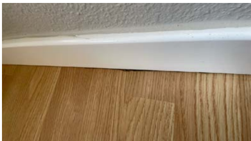
Glippe mellom gulvlist og laminatgulv.
