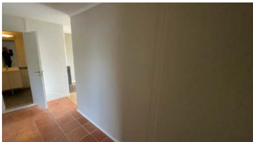
Synlige sparkelskjøter på veggplater.
