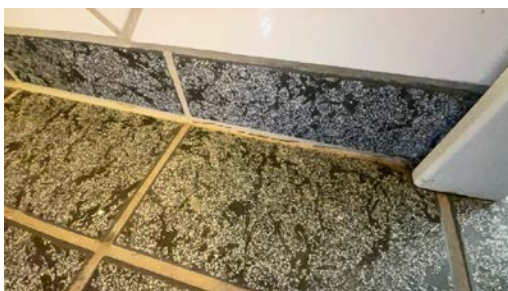
Sprekk i elastisk fuge
