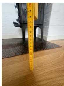
Avvik på planhet i området ved vedovn.
