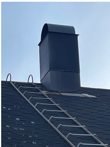
Rust på beslag ved pipe
