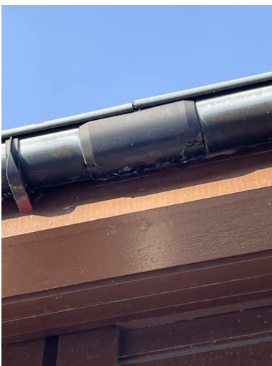
Renneskjøt med lekkasje
