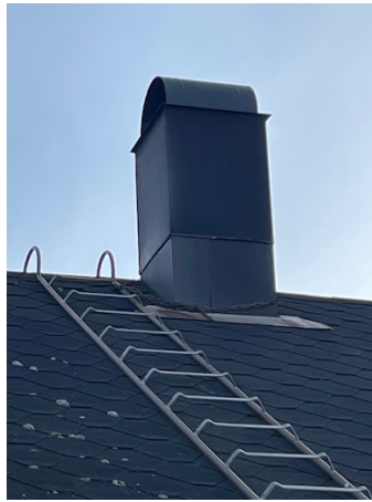
Rust på beslag ved pipe
