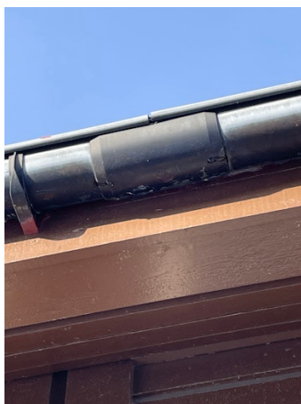
Renneskjøt med lekkasje
