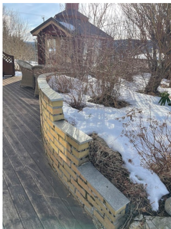
Forstøtningsmur fremstår delvis ute av lodd.
