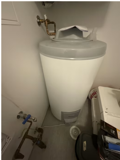
Viser bereder plassert i teknisk rom.
