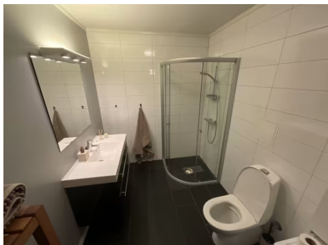
Viser installasjoner på bad.
