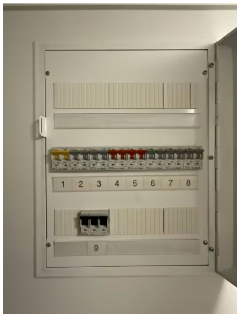
Viser sikringskap plassert på teknisk rom.
