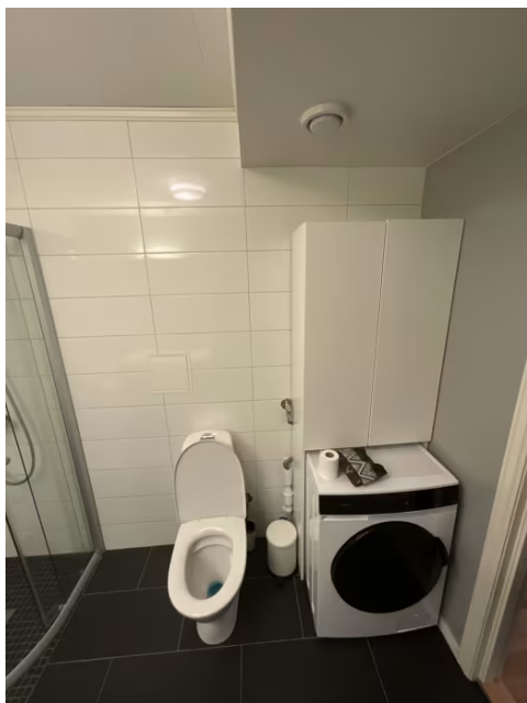
Viser gulvstående toalett og opplegg for vaskemaskin.
