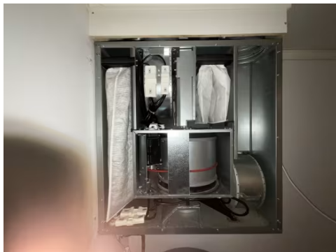
Viser ventilasjonsaggregat innvendig.
