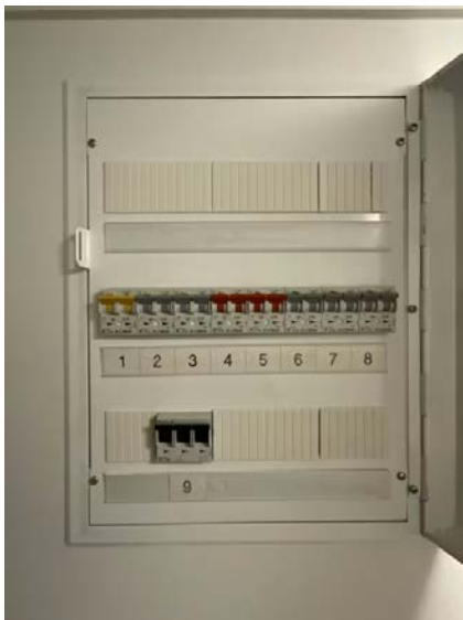
Viser sikringsskap plassert på teknisk rom.
