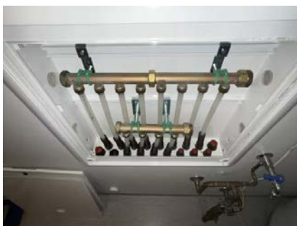
Vannrør med rør i rør system fra fordelerskap plassert teknisk rom frem til
