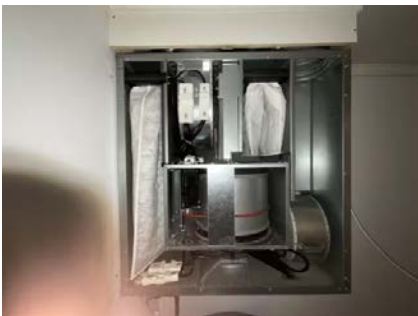
Viser ventilasjonsaggregat innvendig.
