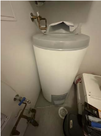
Viser bereder plassert i teknisk rom.
