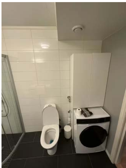
Viser gulvstående toalett og opplegg for vaskemaskin.
