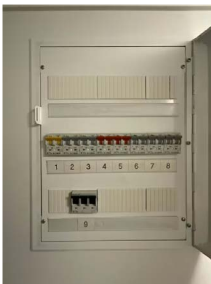
Viser sikringsskap plassert på teknisk rom.
