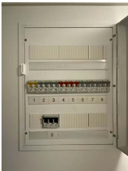
Viser sikringsskap plassert på teknisk rom.
