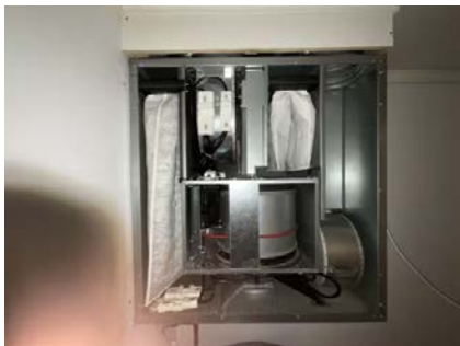
Viser ventilasjonsaggregat innvendig.
