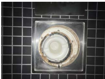
Viser sluk i dusjsonen.
