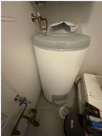
Viser bereder plassert i teknisk rom.
