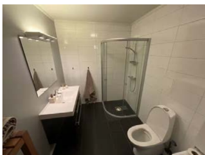
Viser installasjoner på bad.
