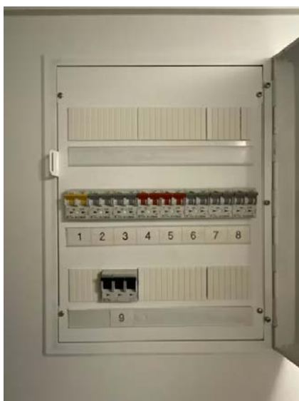
Viser sikringsskap plassert på teknisk rom.
